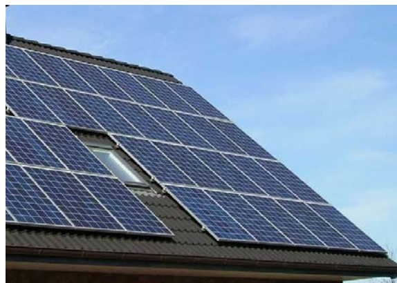
Abb. 73 // Photovoltaikanlage auf Satteldach
